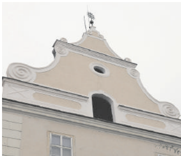
▲ Ist jetzt wieder ein Schmuckstück: Die perfekt sanierte Giebelwand, die bereits massiv gefährdet war, mit der Wetterfahne.
